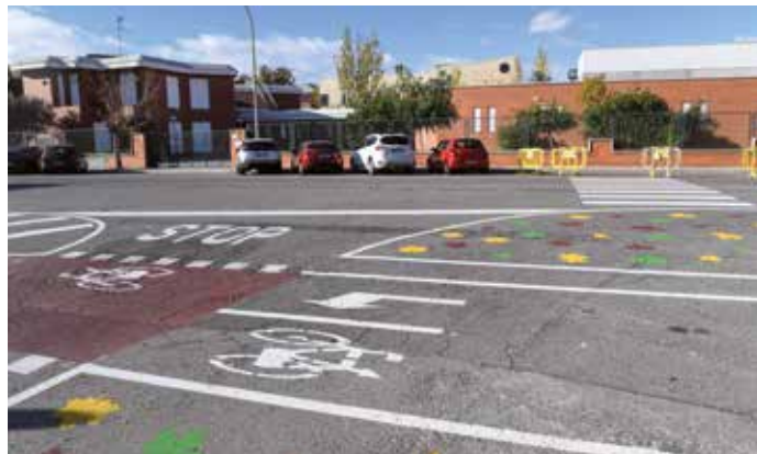
Enllestit el tram del carril bici entre els carrers Narcís Monturiol i Cadenes
